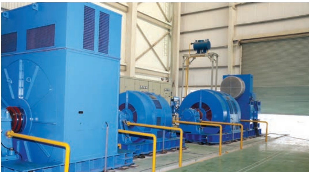
Tổ động cơ máy phát 7500 KVA và 2000 KVA M-G 7500 KVA - 2000 KVA
