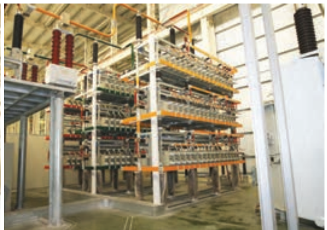
Hệ thống tụ bù 100 MVAR Capacitor bank 100 MVAR
