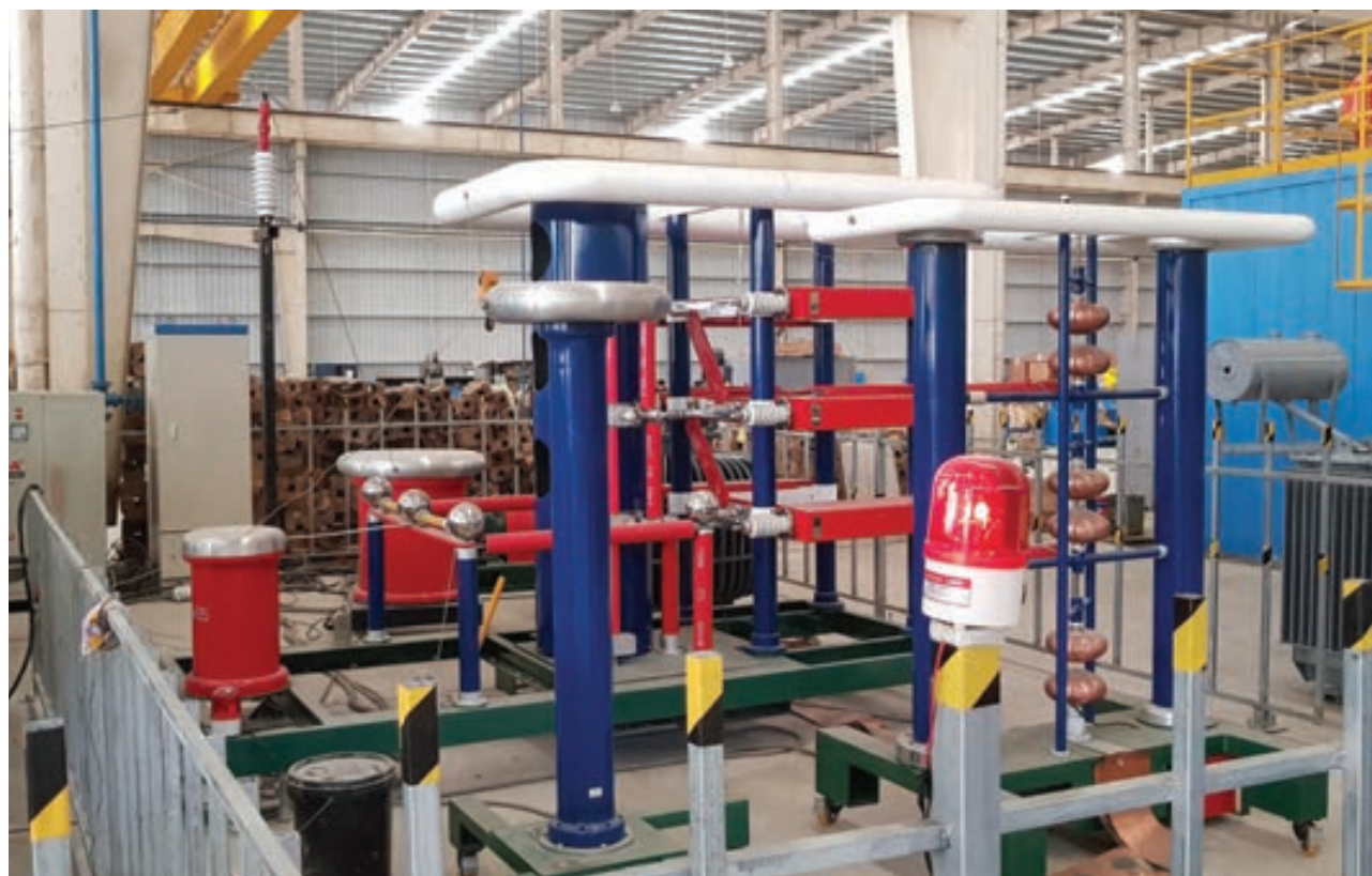
Trạm thử nghiệm máy biến áp - Transformer testing station
