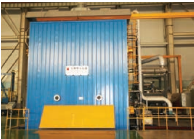
Lò sấy pha hơi Vapor phase drying Plant
